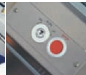
Аварийный выключатель эскалатора
